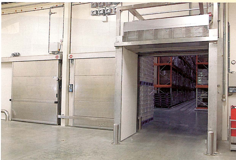
Het vrieshuis-luchtgordijn realiseert een uitstekende klimaatscheiding.
